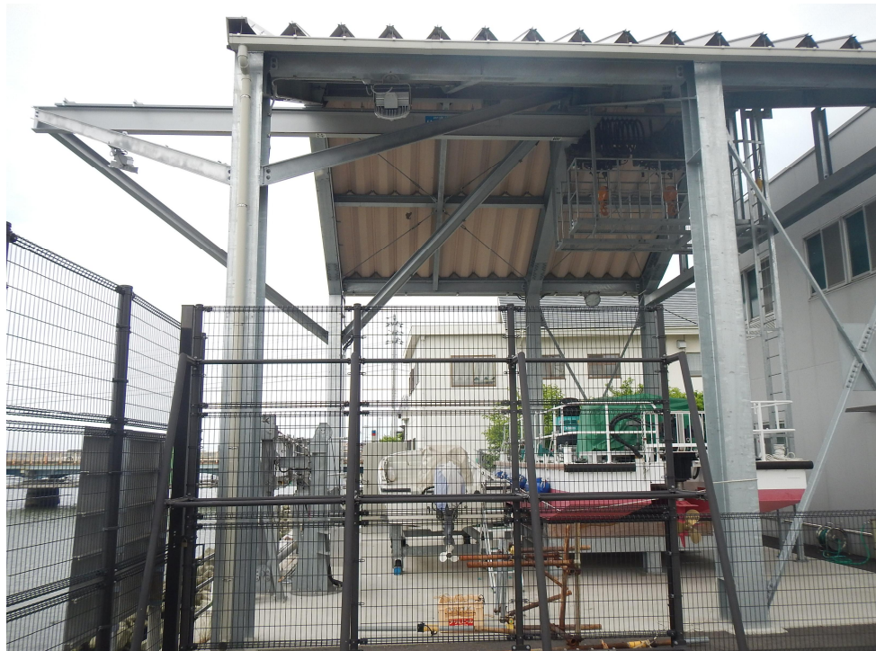
天井クレーン全景
